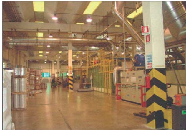
Cartellonistica di sicurezza e dispositivi antincendio
