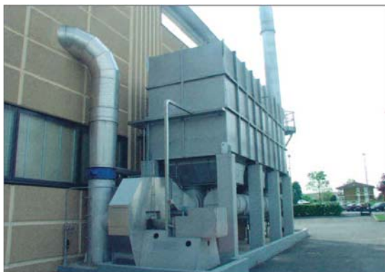
Impianto di depurazione dell'aria
